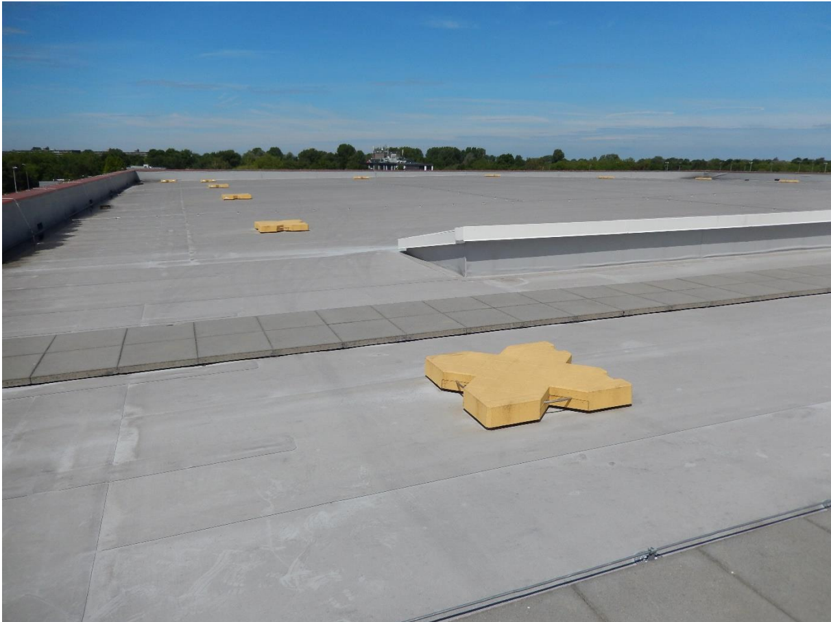
Figuur 2 – Deel van het hoge dak van sporthal De Beuk, waar de zonnepanelen komen te liggen.
